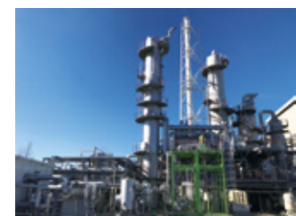
住友共同電力新居浜西火力発電所に設置されたESCAP ®
